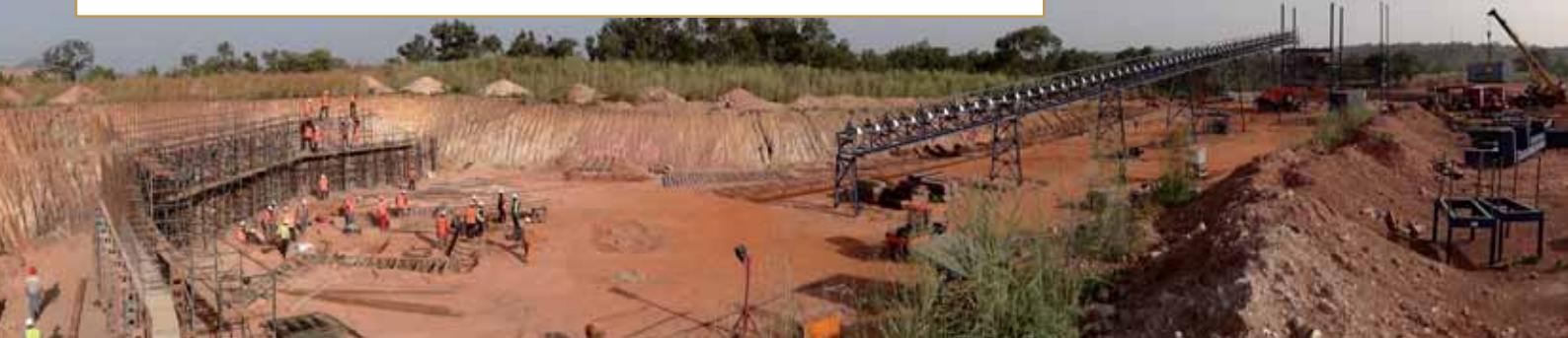
Vue de la nouvelle installation de concassage à Goukoto.
