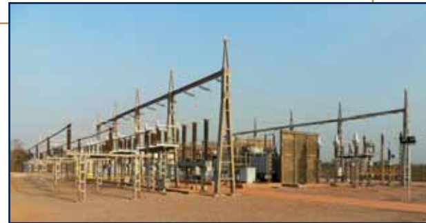
Le raccordement de la mine de Tongon au réseau électrique national, permet déjà d'économiser de l'argent.
